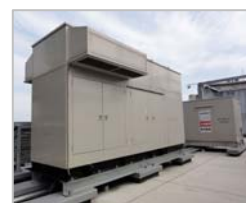
<非常用発電機 イメージ>
